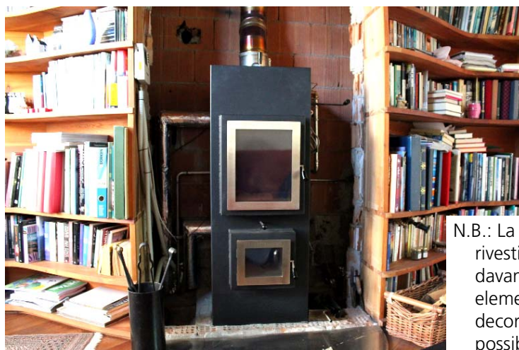
Stufa-caldaia, nel soggiorno
